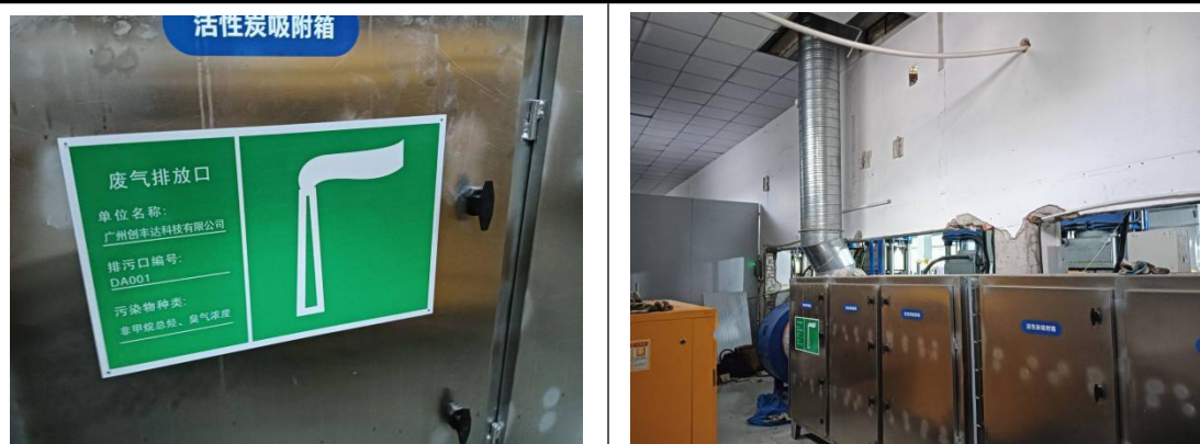
废气排放口标识牌
