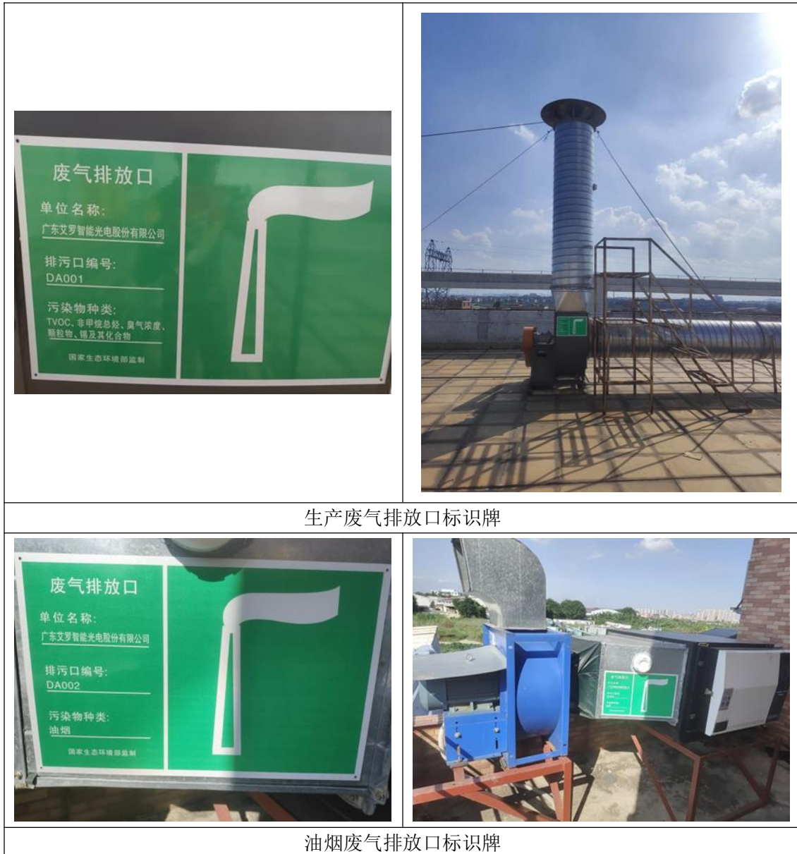
图 4.1-3 废气排放口及规范化设置照片
