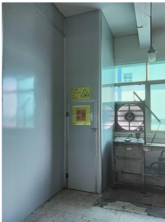
图 4.1-7 危险废物储存室及其规范化标志牌照片
